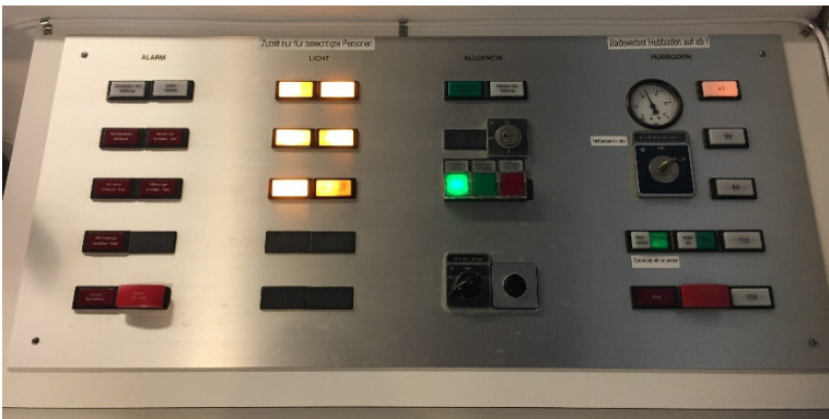
Steuerpult Elektro bei der Badeaufsicht im Hallenbad
