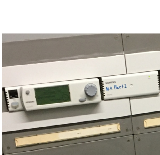
Heizungsregler in der HV Elektro
